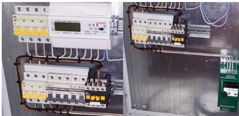
Рис. 10. Подключение электрического щита лабораторного стенда
