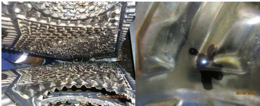
Рис. 3. Повреждение пластин судового теплообменника Alfa Laval [3]
