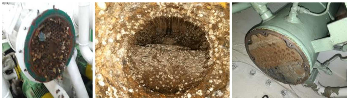
Рис. 2. Состояние кожухотрубного теплообменного оборудования судна снабжения платформ «Атлантик Суппортер» при эксплуатации в акватории Северного Каспия (фото из архива механика судна И.Р. Муханова)
